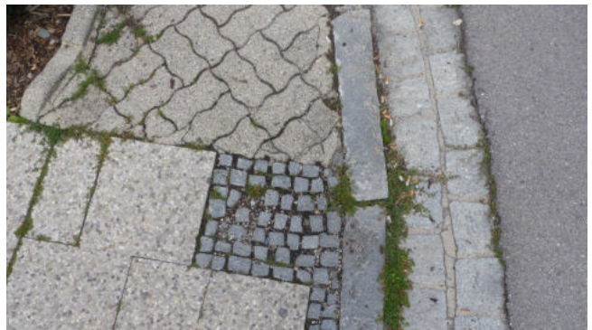
Bahnhofstr., Bsp. Materialmix im Öffentlichen Raum - Schlechter Zustand
